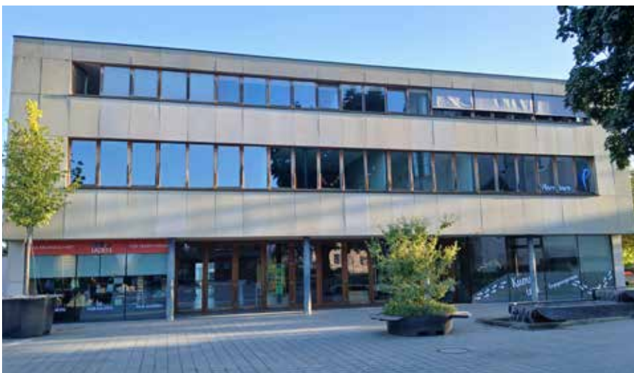
Die Erneuerung des Sonnenschutzes an der Südfassade hat Priorität.
